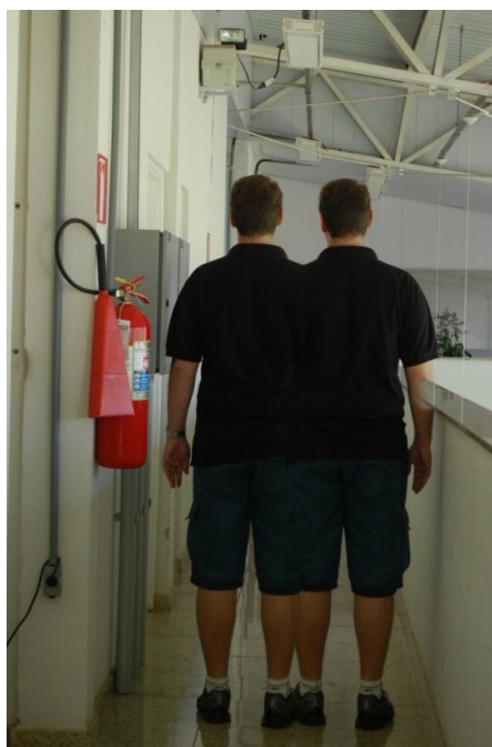
Figura 15 – Sobreposição indicando não conformidade da largura do corredor no pavimento superior. Fonte: Arquivo pessoal.
