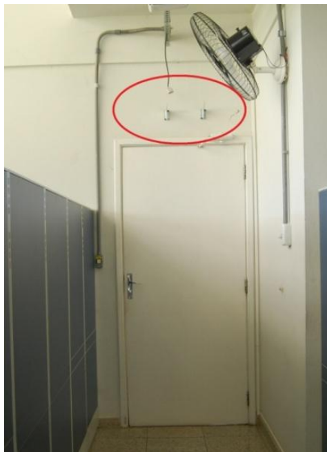
Figura 6 - Ausência de bloco autônomo. Fonte: Arquivo pessoal.
